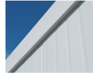
| Fassade mit Sandwich-elementen in RAL 9002
