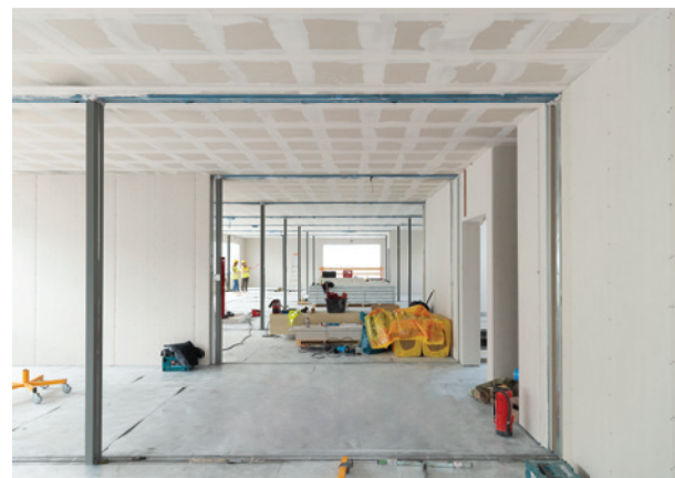
Lichtdurchflutete Räume: Durch die Aufstockung der „Red Box“ entstehen insgesamt 15 neue Büros am ALHO-Hauptsitz Steeg.
