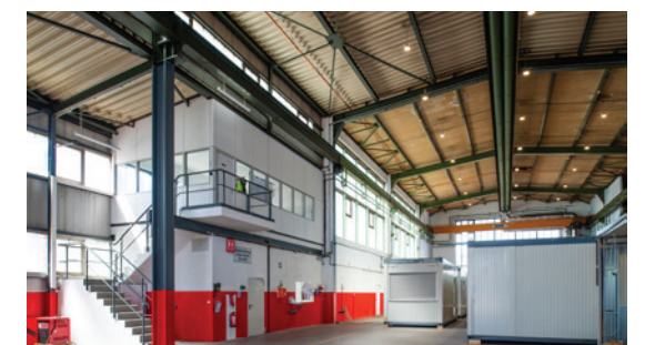
Umbau der Umbauhalle: Zur Schaffung von Produktions- und Büroflächen stehen viele Ausbaurbeiten an.
