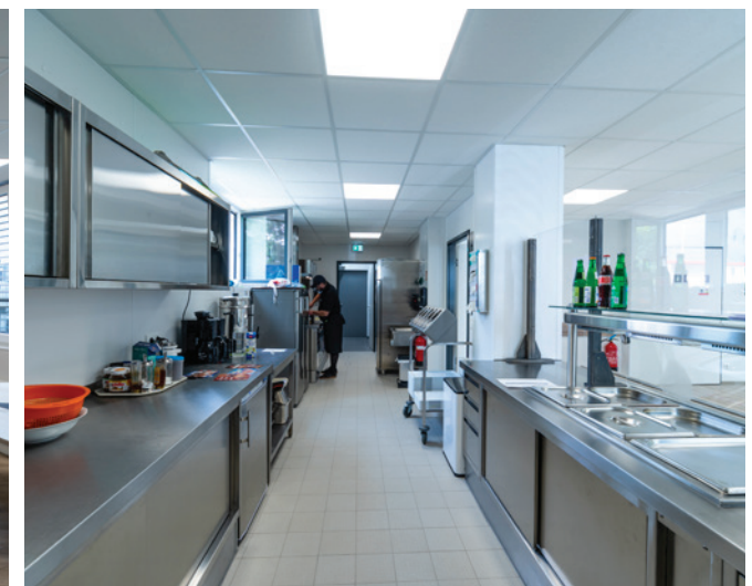
Die professionell ausgestattete Industrieküche umfasst insgesamt ca. 37 m 2 und besteht aus Spülküche, Essensausgabe und Lager.
