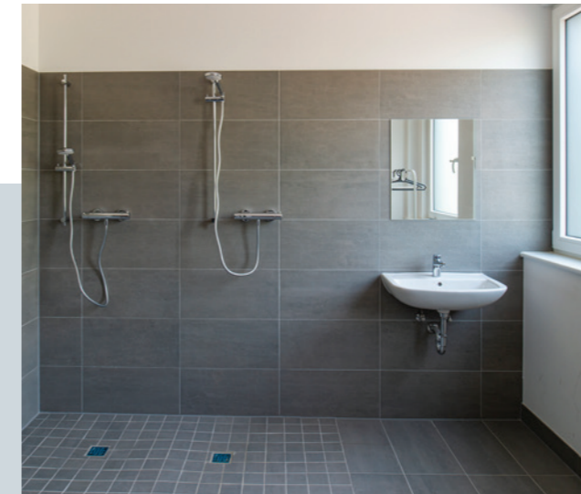
Der Weg in die im EG des Neubaus angesiedelten Duschen und Umkleiden ist für die rund 35 Mitarbeitenden aus der Metallveredelung nicht weit.
